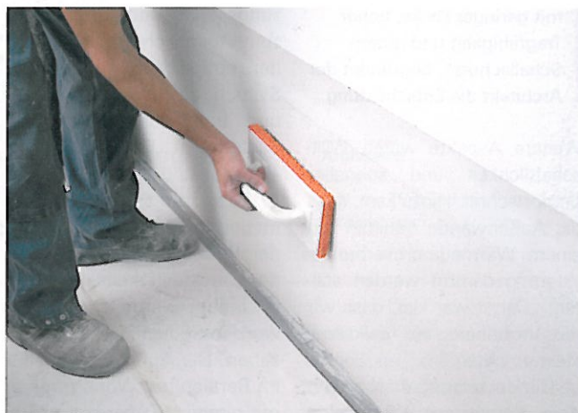
Mit einer inneren Abdichtung des Wand-Sohlen-Anchlusses konnte ein dauerhafter Feuchteschutz installiert werden.
